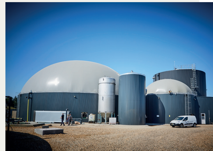
Det nybyggede Comibigas gårdbiogasanlæg, der ligger få km fra både Sjoerd Ydemas mælkeproduktion og Arla Rødkærsgade, der aftager biogassen.
